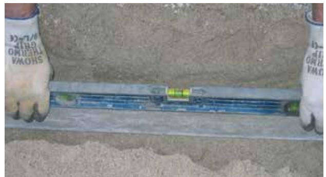
Stendere un letto di cemento a profondità del canale, facendo attenzione a non dare alcuna pendenza
