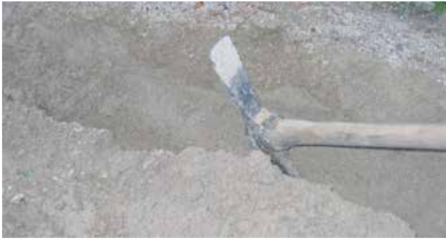
Realizzare una traccia nel terreno 10 cm più larga e 5 cm più fonda dei canali da posare
